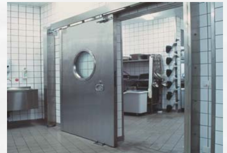
Feuerschutz-Schiebetor in einer Großküche.
